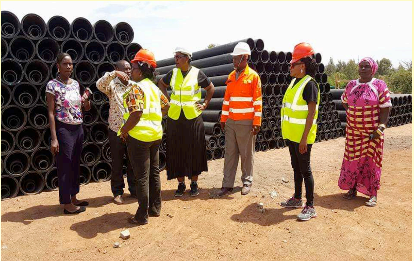
Moja ya ziara ya kukagua wakandarasi wa mradi wa maji kuona vifaa vya mabomba yanayotumika katika mradi mkubwa wa maji unaosimamiwa na MWAUWASA
